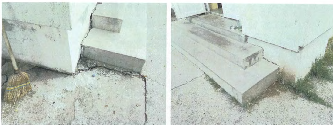
Foto nr. 13a, b – Aspect degradări scări de acces
