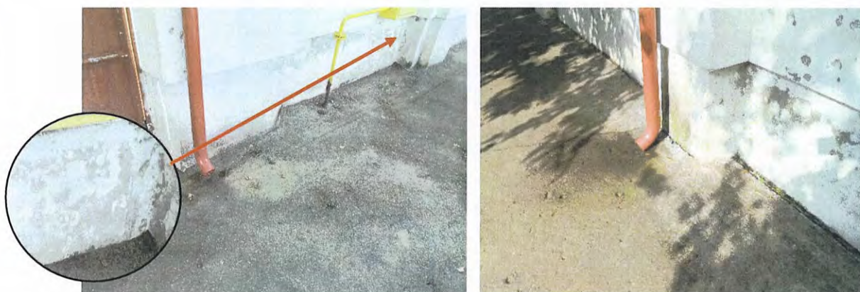
Foto nr. 8 a, b – Aspect degradări (igrasie) tencuieli - soclu
