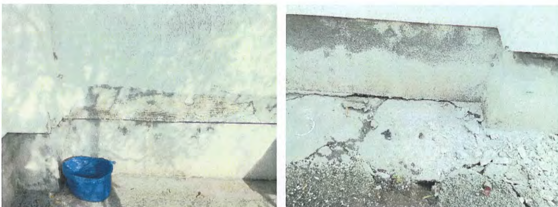
Foto nr. 9 a, b – Aspect degradări tencuieli - soclu
