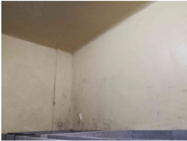
Degradări tencuiei interioare
