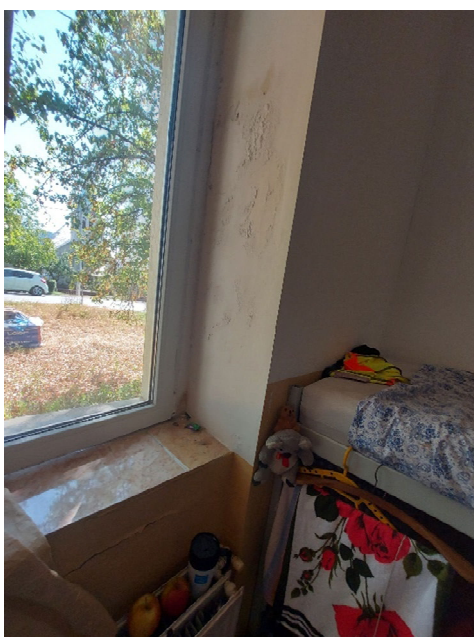
Tencuiei scorojite pe zona spașeșilor tãmplãriei exterioare
