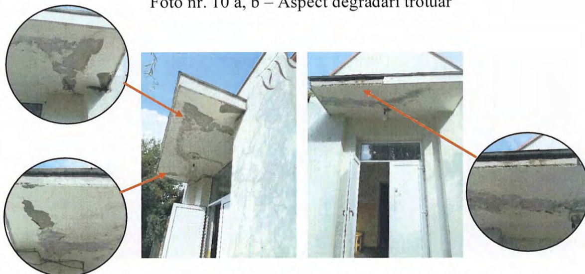
Foto nr. 11 a, b – Aspect degradări tencuieli și finisaje–copertină acces
