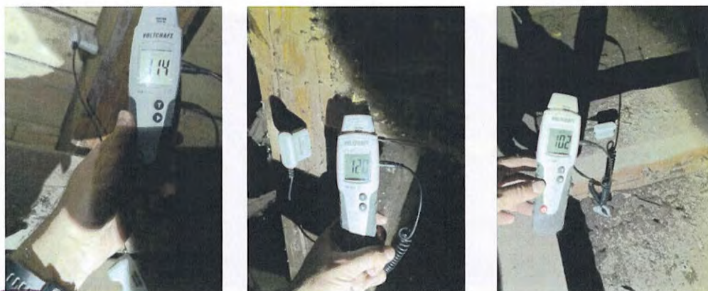
Foto nr. 58 a, b, c– Aspect sondaje umiditatea elementelor din lemn
